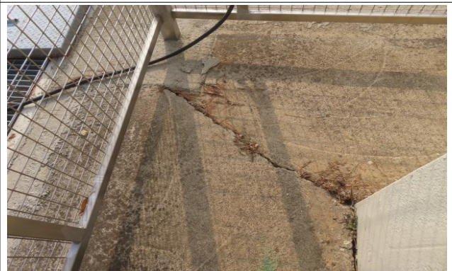
계단실 기초하부 균열(0.3mm이상)
