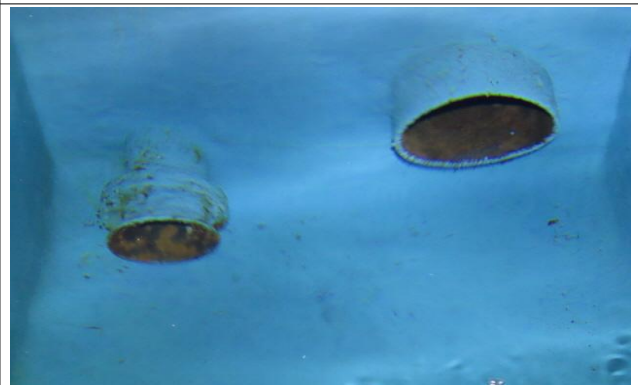
배수지 1지 유출 배관 관부식
