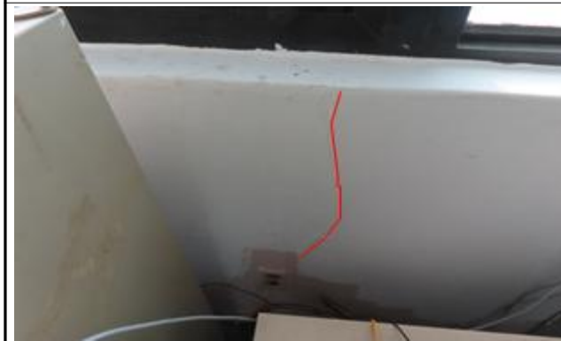
기타건축물(관리동) 내부 균열(0.3mm미만)
