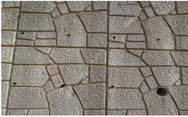
주변옹벽 옹벽 균열(0.3mm미만) (Sta. 38.0m)
