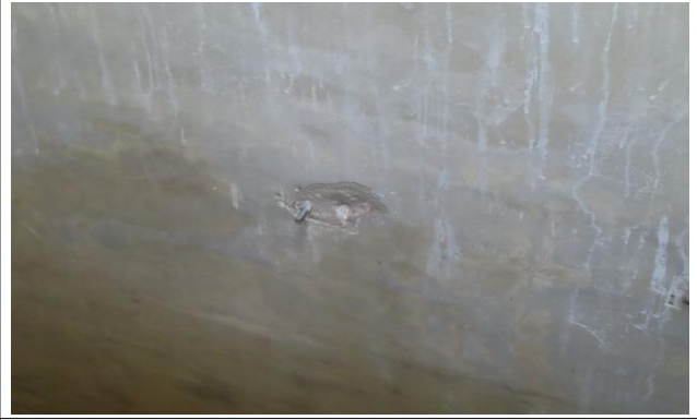
유출밸브실 1지 파손
