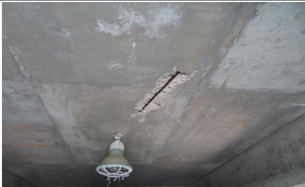
계단실 내부 철근노출 (상반기)
