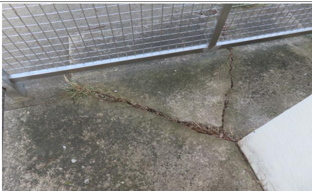
계단실 기초하부 균열(0.3mm이상)
