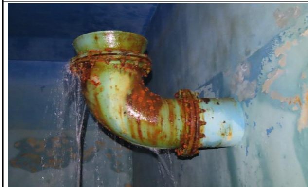
배수지 1지 유입 배관 관부식
