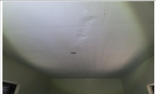
계단실 내부 철근노출 (하반기) (보수)
