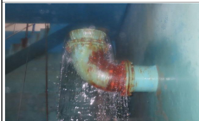
배수지 2지 유입 배관 관부식
