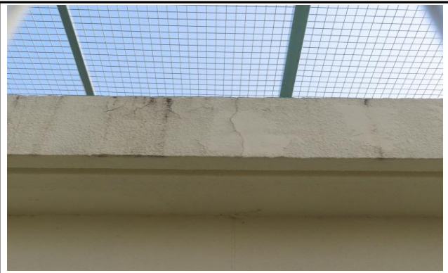
계단실 외부 균열(0.3mm미만)
