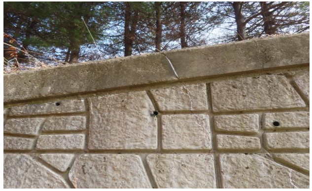
주변옹벽 옹벽 균열(0.3mm미만) (Sta. 47.0m)
