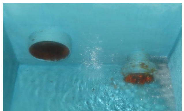
배수지 2지 유출 배관 관부식
